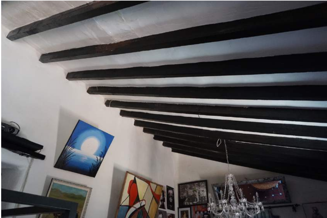
Figura 14. Detalle de los techos y vigas de madera de la vivienda principal. Elaboración propia.
