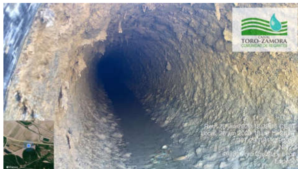
Interior tubería de PRFV en la red de riego de la CRT-Z
