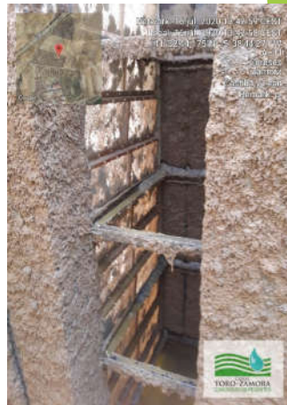
Cántara de aspiración en balsa de acumulación de la CRT-Z
